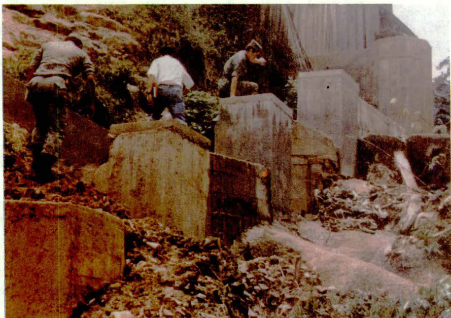
Construcción de cámaras de caída: Alcantarillado del barrio "Las Malvinas". Florencia - Caquetá. BATIN No. 12 "Liborio Mejía".
