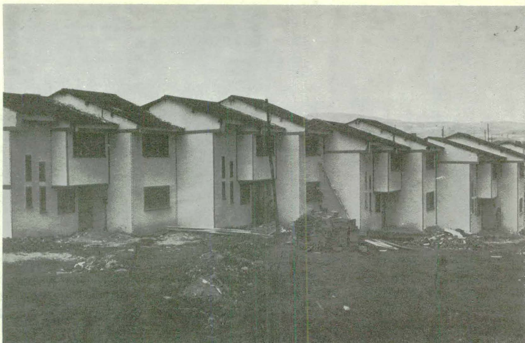
Aspectos de las viviendas para suboficiales que se encuentran en ejecución en la Guarnición de Sogamoso
