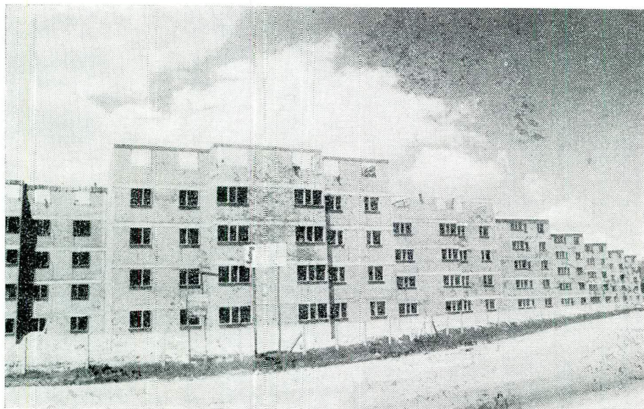
Conjunto Residencial de 360 Apartamentos "Ayacucho" Segunda etapa para Suboficiales en Ciudad Kennedy.
