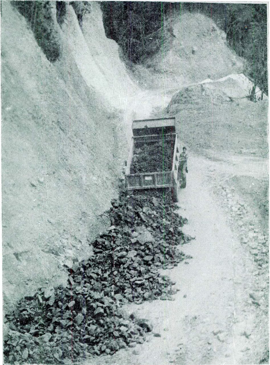
Aspecto que muestra la reconstrucción de un tramo de la carretera SARDINATA-LAS MERCEDES. La vía atraviesa una zona geológicamente inestable. Lo que ha obligado en repetidas ocasiones, a acometer su reconstrucción por la causa anotada. La obra es adelantada por el Batallón CALDAS.
