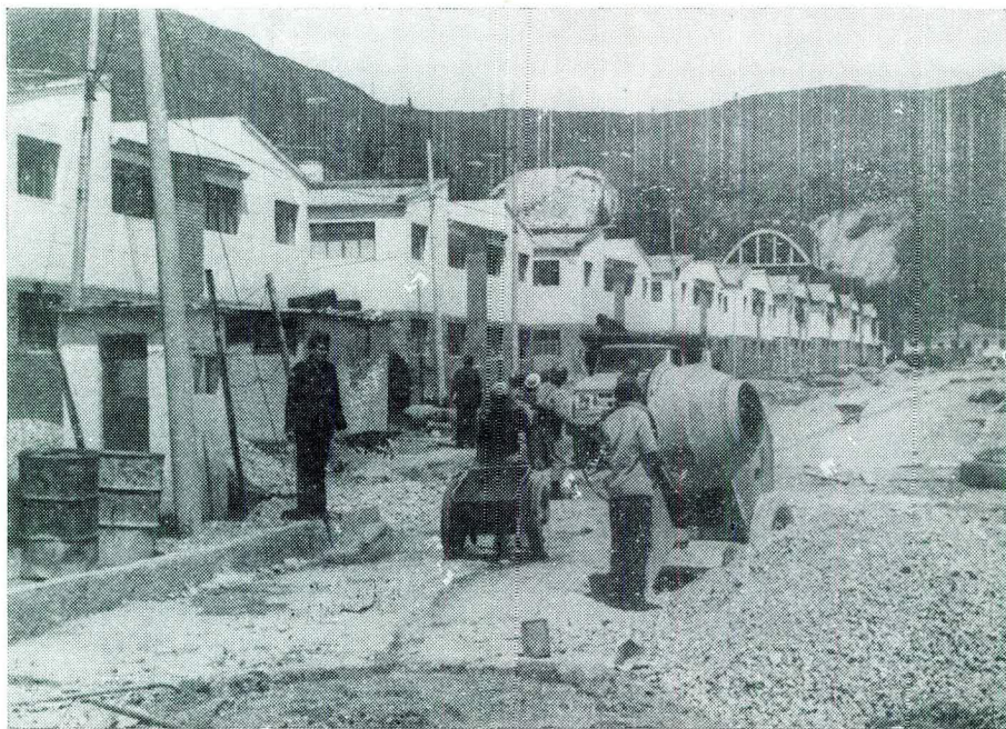
Trabajos de pavimentación de las vías de casas fiscales en la ciudad de Bogotá, Sector Usaquéen, obra ejecutada directamente por personal del Instituto.
