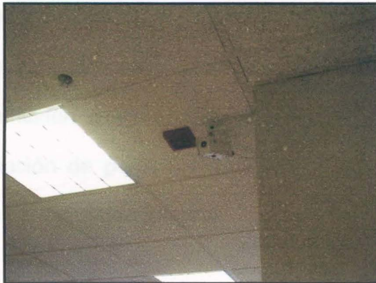
Sistema de CCTV oficinas BP EXPLORATION.
