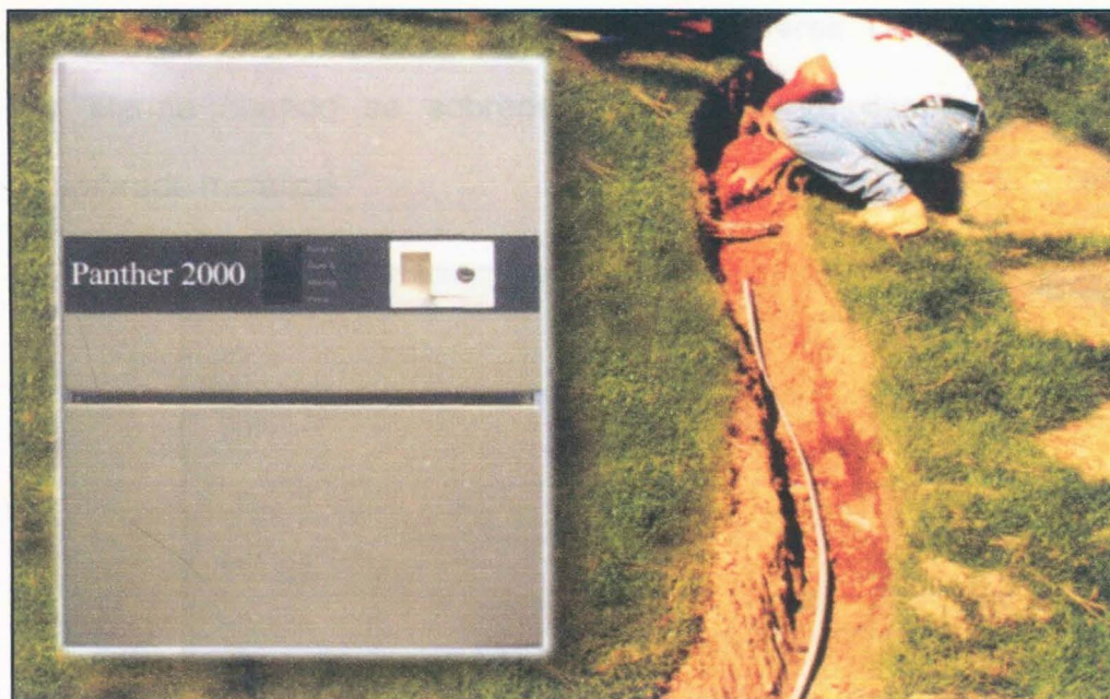
Instalación de un cable sensor para la detección de intrusos. Referencia PANTHER 2000 del Maqal Group
