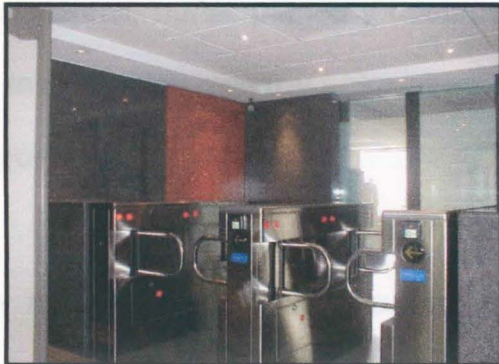
Sistema de control de acceso (torno) oficinas BP EXPLORATION
