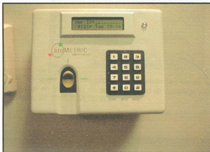
Sistema de control biométrico para áreas de alta seguridad. Entrada presidencia BP Exploration. Bogotá D.C.
