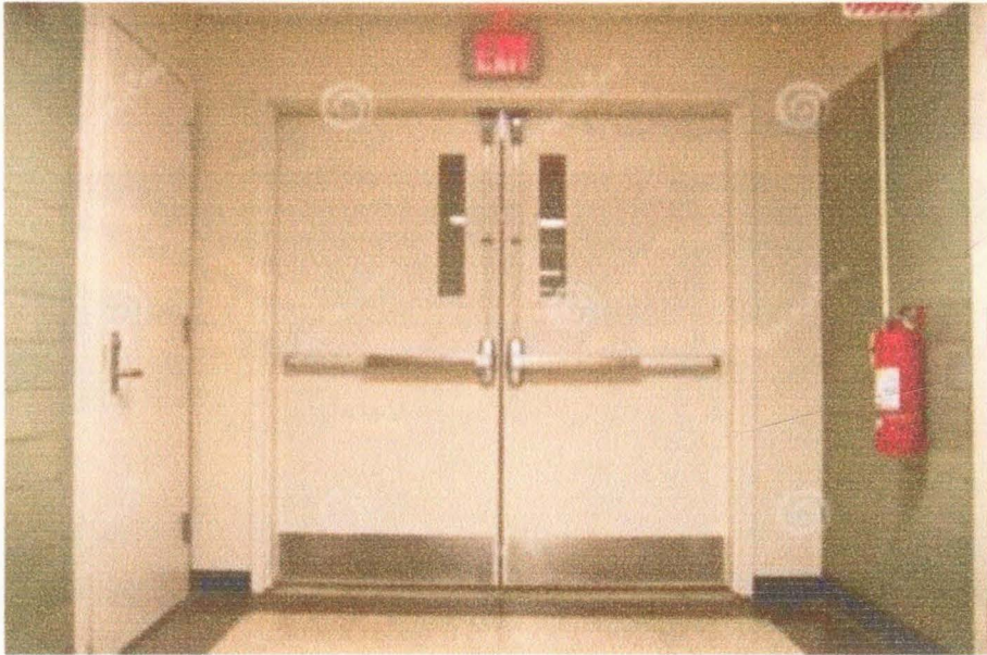
Figura 27. Salida de emergencia
