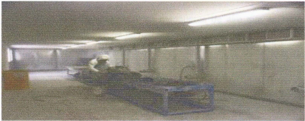
Figura 29. Cabina de pinturas
