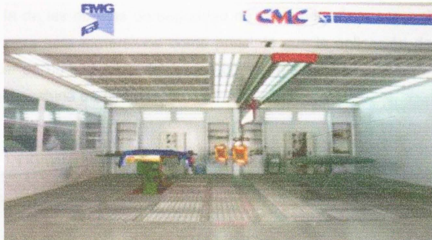
Figura 28. Iluminación taller de pinturas
